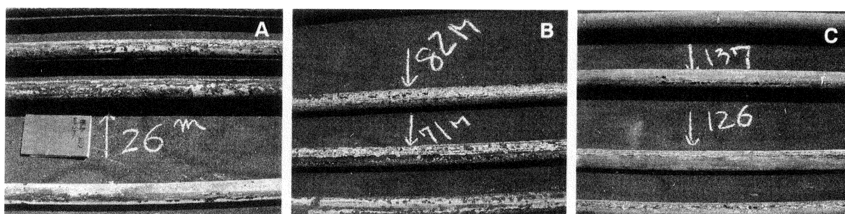
第5図 腐食の状況 Fig. 5 A condition of corrosion.
