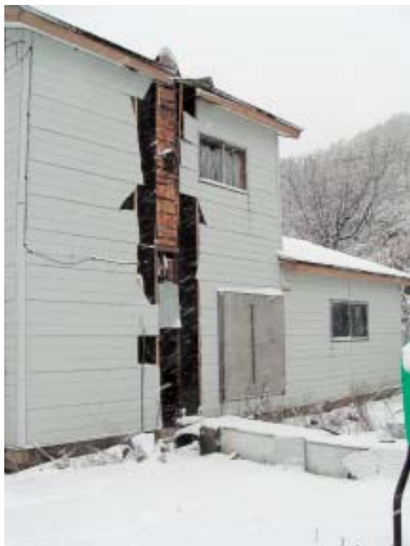
写真4 小平町広富の人家に見られた煙突の倒壊。
