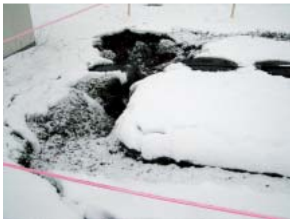
写真6 小平町鬼鹿市街のおにしか更生園浄化槽の抜け上がり。
