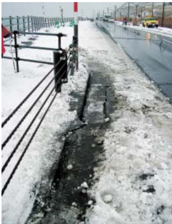
写真1 国道232号線小楸子川の北側における、路側帯の沈下による舗装面の亀裂。
