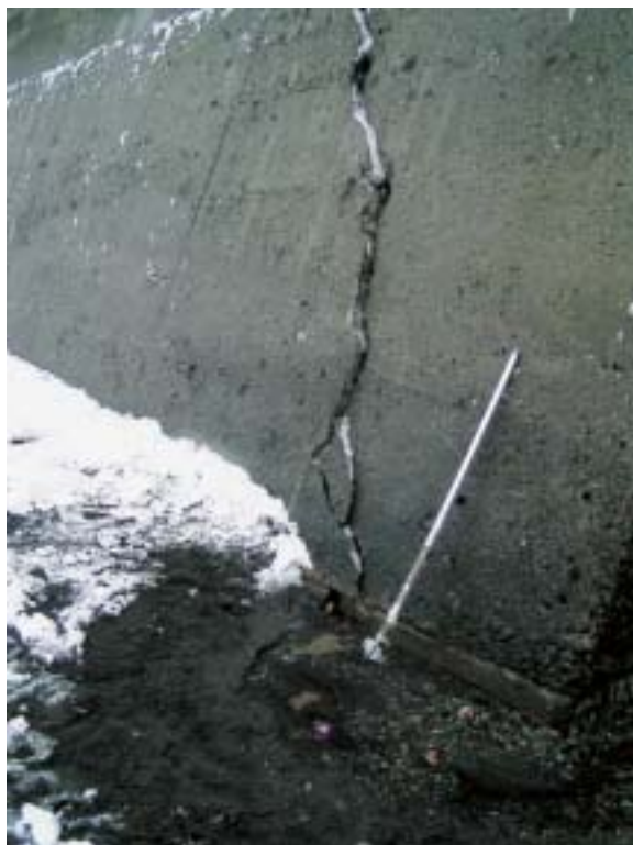
写真2 国道232号線, 小楸子川河口における防波擁壁の破損, 海側へのわずかな傾倒。
