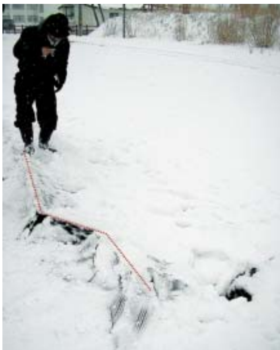
写真3 小平町鬼鹿市街南東の海成段丘面上に敷設されている道路舗装面に観察された, 圧縮による盛り上がり(点線はリッジ)。
