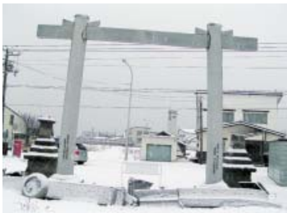
写真12 小平町鬼鹿市街, 巖島神社における鳥居頂部の崩落被害.
