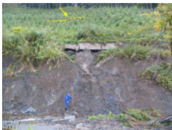
第23図 平取町幌毛志(Loc. 9)の地すべり末端の押し出し。矢印は斜面中腹に生じた段差。写真中央部のコンクリートは水路溝。 Fig. 23 Slope failure occurred at the toe of a landslide at Horokeshi.
