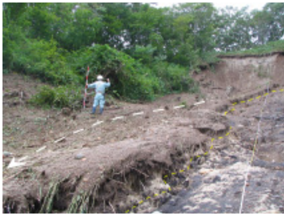
第8図 軽石/腐植土のすべり面(黄色破線)と溢流した(白色破線矢印)崩壊堆積物。 Fig. 8 Slide surface between pumice/kuroboku soil and overflow of collapse deposits.
