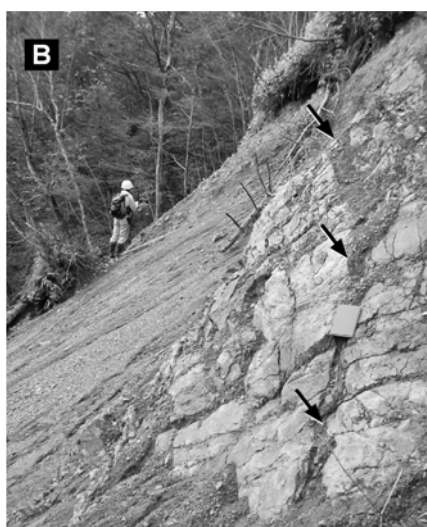
写真4 (A)タイプ1岩盤崩壊の平板な崩壊面。基岩には崩壊面に平行な亀裂が見える(矢印)。 (B)斜面上部に露出する砂岩頁岩互層に認められる、楔状の開口亀裂(矢印)。 Photo 4 (A) Parallely oriented planar rupture surface of the Type 1 failure and fractures (white arrows) in a bedrock. (B) Wedge-shape open fractures (black arrows) observed in a bedrock at the upper part of the failed slope.
